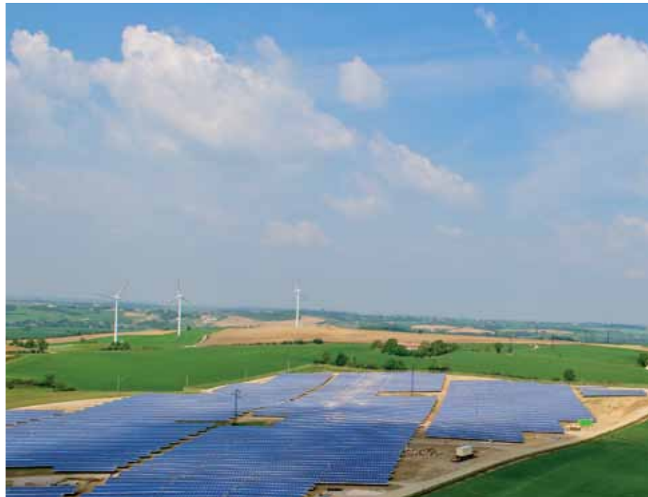
Avignonnet-Lauragais : parc d'exploitation d'énergie renouvelable mixte (éolien et solaire) exploité par Boralex
